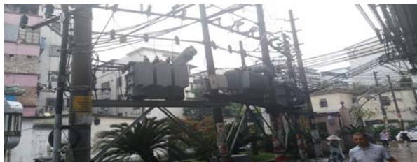
图 1 云南某 3 个变压器在一起的“背靠背”台区
